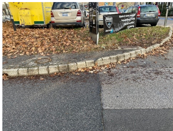
Slika 22: Visok robnik, ki predstavlja oviro za gibalno ovirane, vzdolž Mašera-Spasičeve ulice
