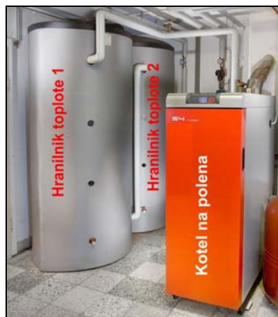
Slika 44; Kotel na polena z dvema hranilnikoma toplote (Vir: www.Fröling )
