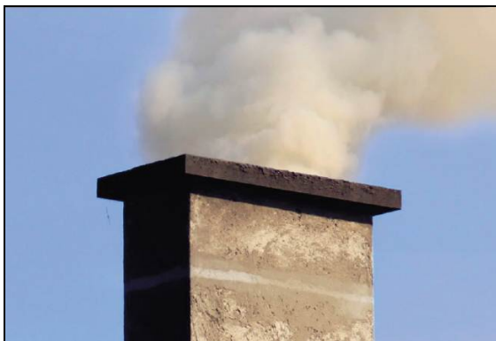
Slika 19; Temnejši ali temen gost dim na vrhu dimnika je pokazatelj zelo slabega zgorevanja
