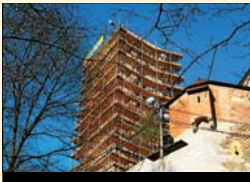
Na Gradu trenutno poteka več obnovitvenih del: dobili bomo nov infocenter, nov bo Friderikov stolp, v Razglednem stolpu pa prenavljajo stopnišče, fasado, kamen, zgornji nivo in dodajajo varnostno opremo.
