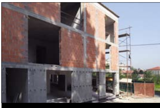
Intenzivno potekajo gradbena dela za prvi hospic v Sloveniji na Hradeckega, ki bo odprl vrata konec leta.
