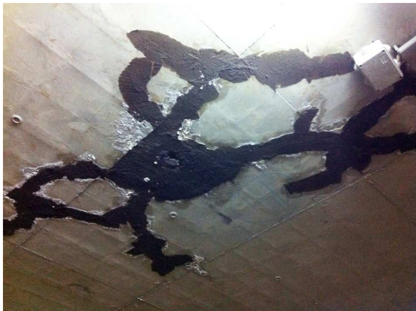
Slika 7: garaža – razpoke in zamakanje na stropu v vseh treh garažah – predhodna sanacija
