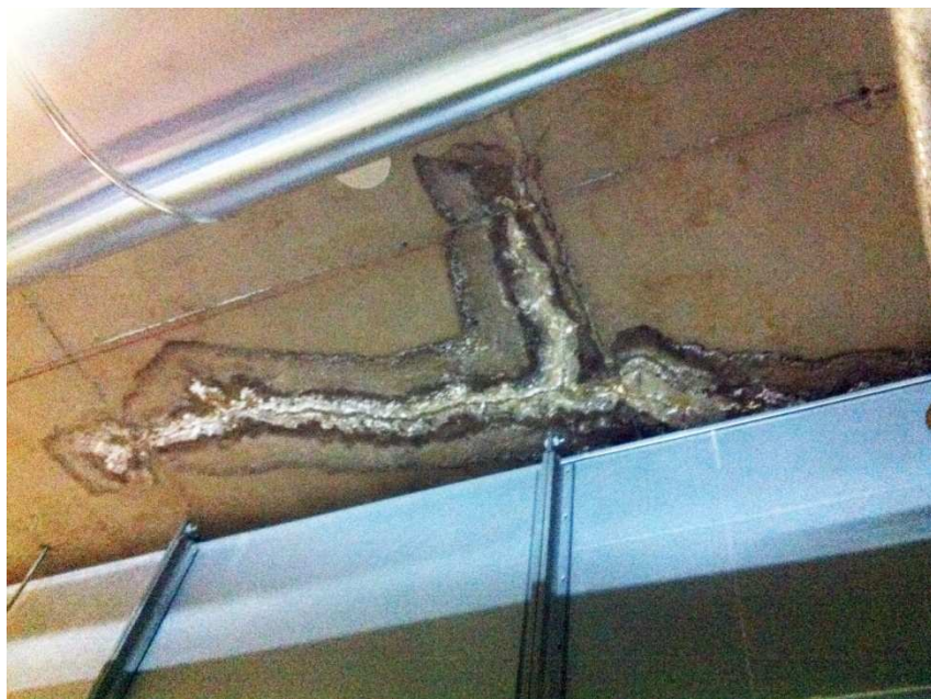
Slika 5: garaža – razpoke in zamakanje na stropu v vseh treh garažah
