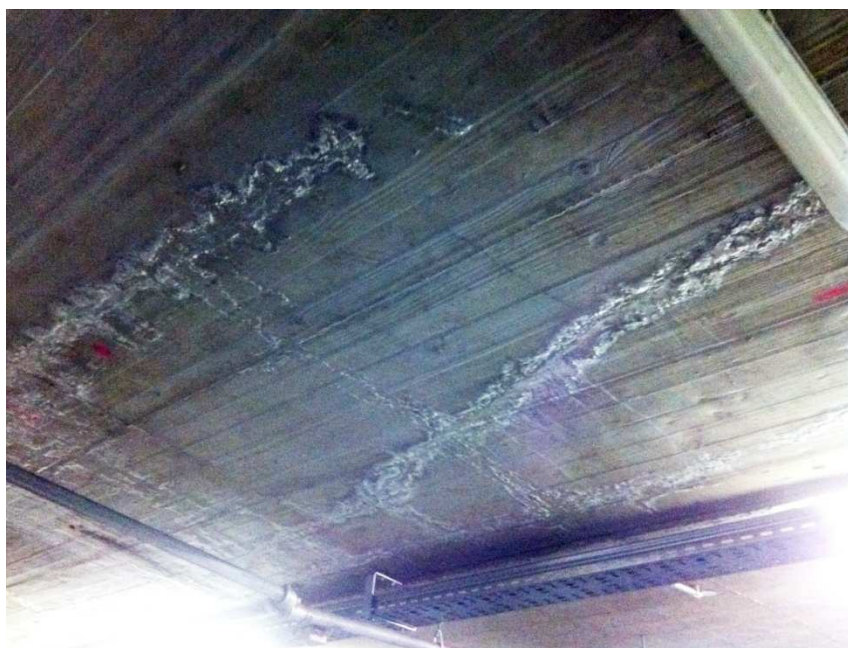
Slika 6: garaža – razpoke in zamakanje na stropu v vseh treh garažah
