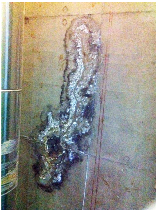
Slika 8: garaža – razpoke in zamakanje na stropu v vseh treh garažah
