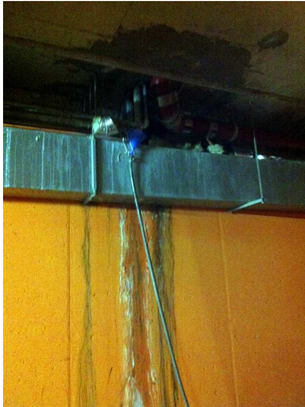
Slika 3: garaža 1 – zamakanje pod pasažo
