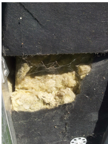
Slika 1: Manjkajoči kosi izolacije
