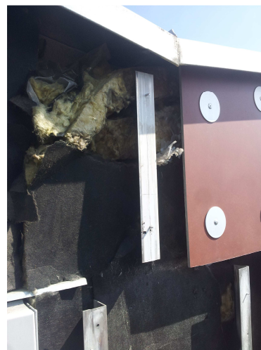
Slika 3: Povešena oz poškodovana izolacija
