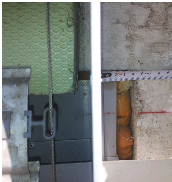
Slika 9: Detajl 3 - vgradnja okna XPS toplotna izolacija ne sega do profila rolet
