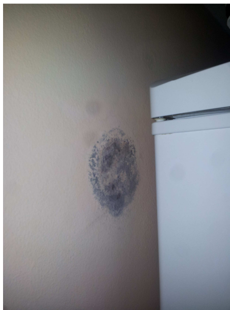
Slika 13: Nastanek točkovne plesni v kuhinji - predvidoma zaradi neobdelane opažne odprtine (stan. št. 13)
