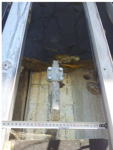
Slika 15: Manjkajoča izolacija na poziciji merilnega mesta za strelovod
