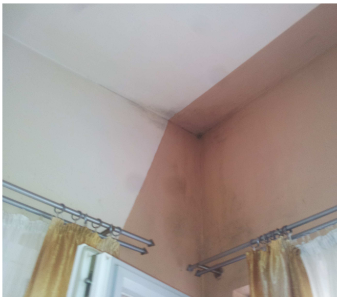
Slika 12: Stanje znotraj stanovanja na mestu odstranjenih plošč (vogal južne in zahodne fasade), nastanek zidne plesni v stanovanju št.13 (Saveljić)
