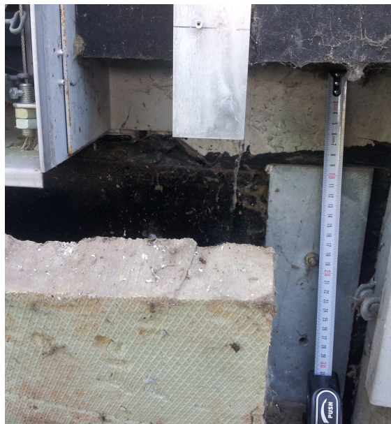
Slika 18: Manjkajoča izolacija med coklom in fasado, izrazit toplotni most, ter neizoliran nosilec betonskega prefabrikata
