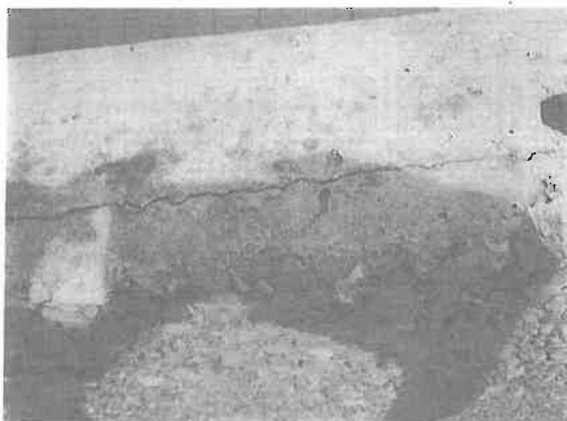
12. Na posameznih lokacijah teraco obloga odstopa tudi na prefabriciranih AB elementih
