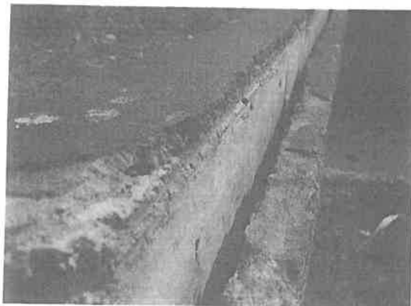
Tipične poškodbe in odstopanje teraco ometa
