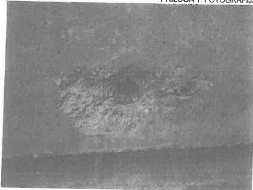
22. Tipične manjše lokalne poškodbe na mestih pritrditve opaža
