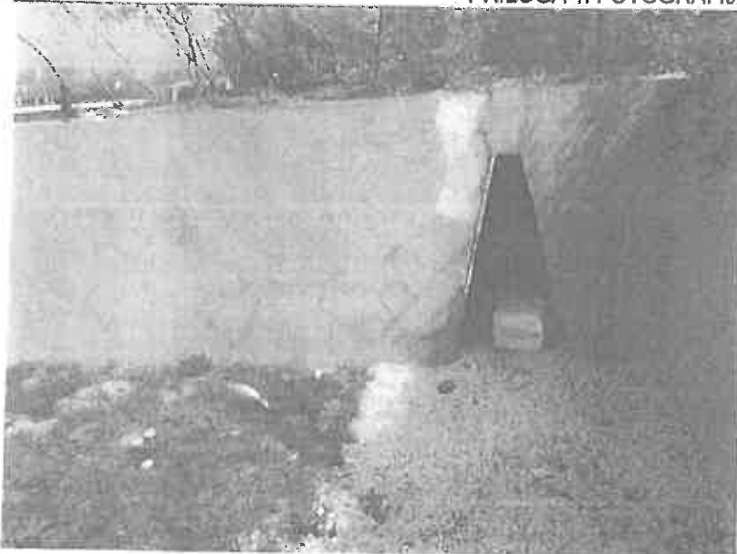
7. Tipične poškodbe in odstopanje pranege, teraco ometa
