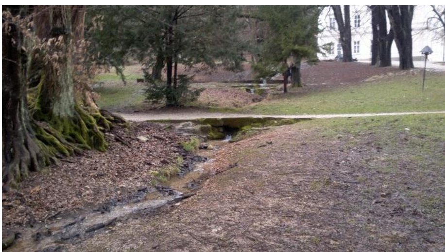
Slika 3c: Površinski padavinski odtok skozi pod-dimenzioniran cevni prepus
