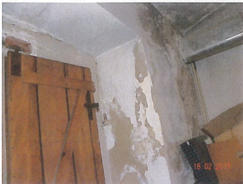
Slika 4.9 P-R39 zamakanje, odpadanje ometa z zidov v pritličju
