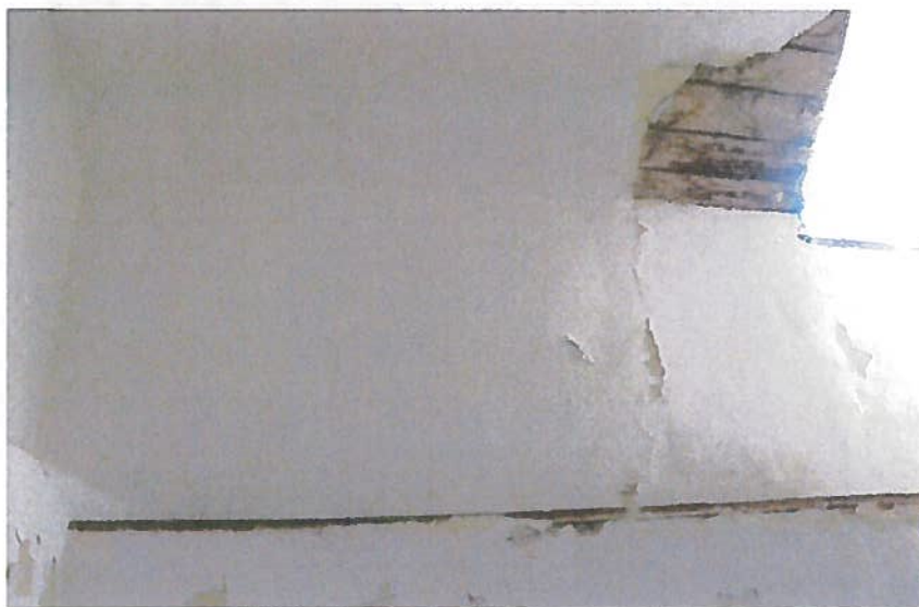
Slika 4.24 problemi zaradi zamakanja strehe v mansardi
