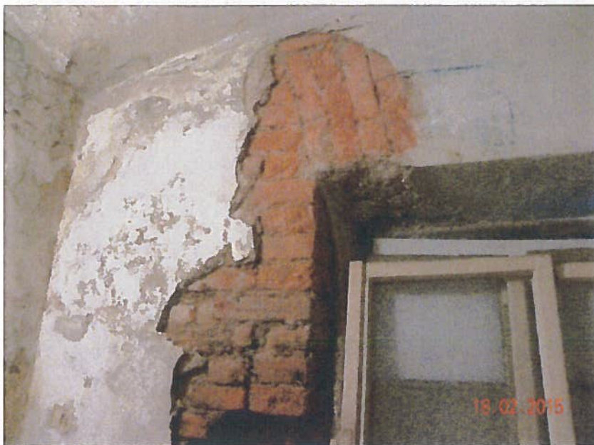
Slika 4.12 sonda P-Z3 – opečni zid in opečni lok nad oknom
