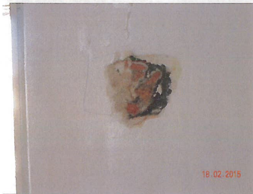
Slika 4.10 sonda P-Z1 zunanji zid
