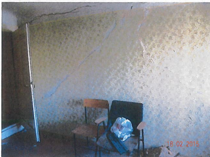
Slika 4.27 razpokani zidovi v mansardi
