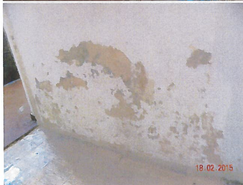
Slika 4.8 P-R35 zamakanje, odpadanje ometa z zidov v pritličju
