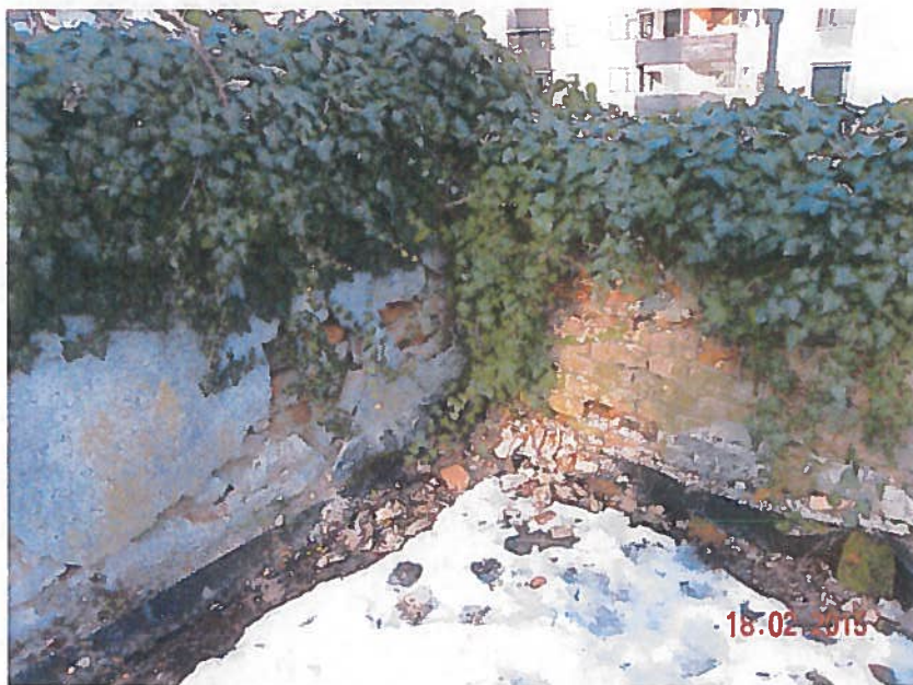
Slika 4.30 streha pomožnega objekta in razpadli parapet
