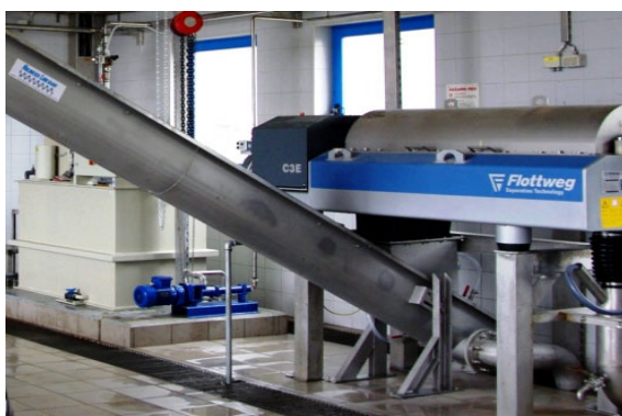
Naprava za strojno zgoščanje blata na ČN Črnuče
