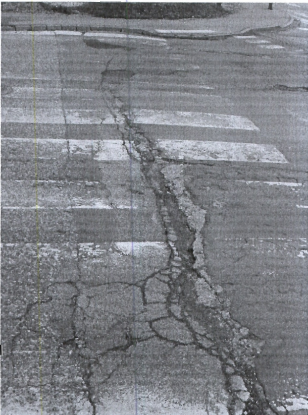
Slika 3: Poškodbe na križišču Pesarske
