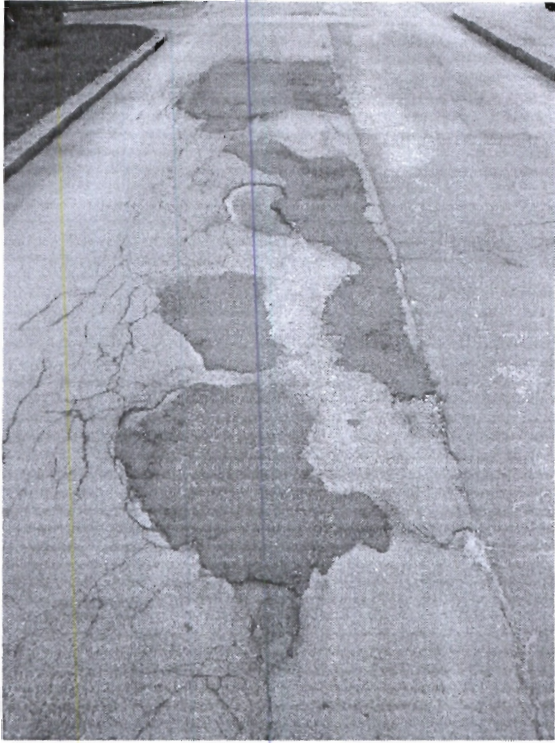
Slika 5: Nepravilna sanacija na Zarnikovi ulici
