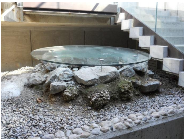
Slika 61: Vodnjak. Kondenzacija vlage na notranji površini steklenih plošč. Stanje na dan 5. 3. 2013. Foto Matjaž Bizjak.
