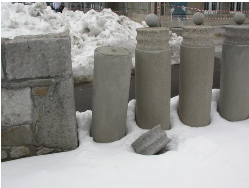
Slika 42: Rimski zid. Poškodovan steber. Stanje na dan 5. 3. 2013. . Foto Matjaž Bizjak.
