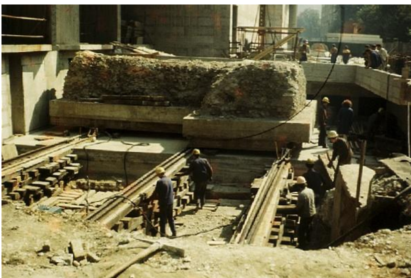
Slika 29: Gradbena dela ob prezentaciji zahodnega zidu pri Cankarjevem domu. Foto dokumentacija MGML.
