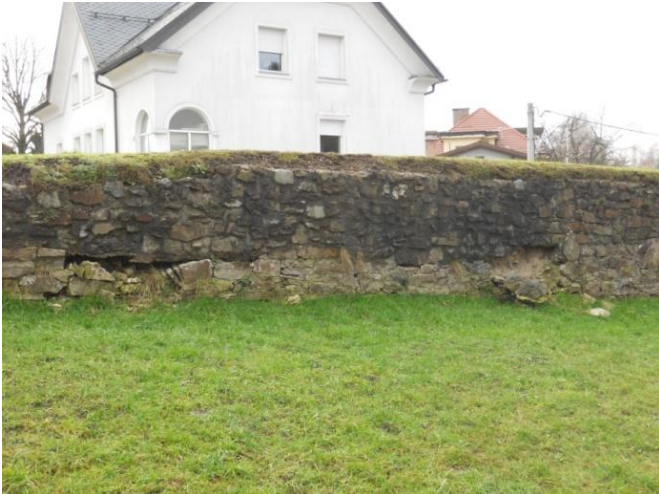
Slika 40: Rimski zid. Mehanske poškodbe na notranji strani zahodnega dela zidu. Stanje na dan 3. 1. 2013. . Foto Matjaž Bizjak.
