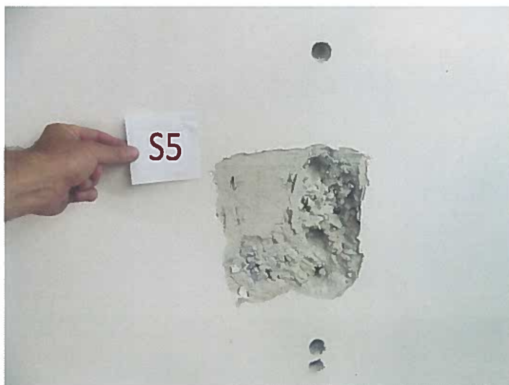
Slika 6: Sonda na mestu vpetja stebra S5 spodaj (segregacija betona)
