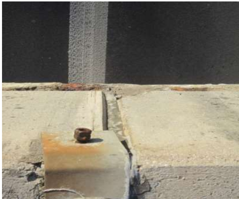
Fotografija 4 – razmajan vijak nad obvoznico, ki je potencialno nevaren, da pade na spodaj vozeče vozilo
