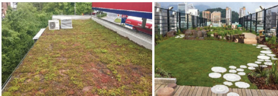
Slika 32 in Slika 33: primerjava zelene strehe in aktivne zelene strehe, levo: zelena streha BS Petrol Ljubljana, desno: aktivna zelena streha Budimpešta, Madžarska (vir: Ozelenitev streh in vertikalnih površin, priporočila MOP, 2021).
