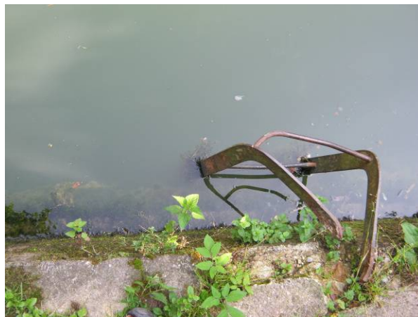
Slika 4: Dotrajana železna lestev, ki vodi iz vode na betonski plato nad zapornico na desnem bregu
