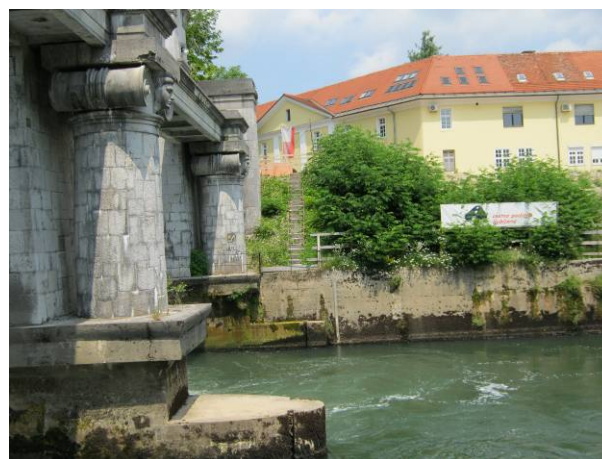
Slika 20: Strme betonske škarpe vidri onemogočajo prehod čez zapornico
