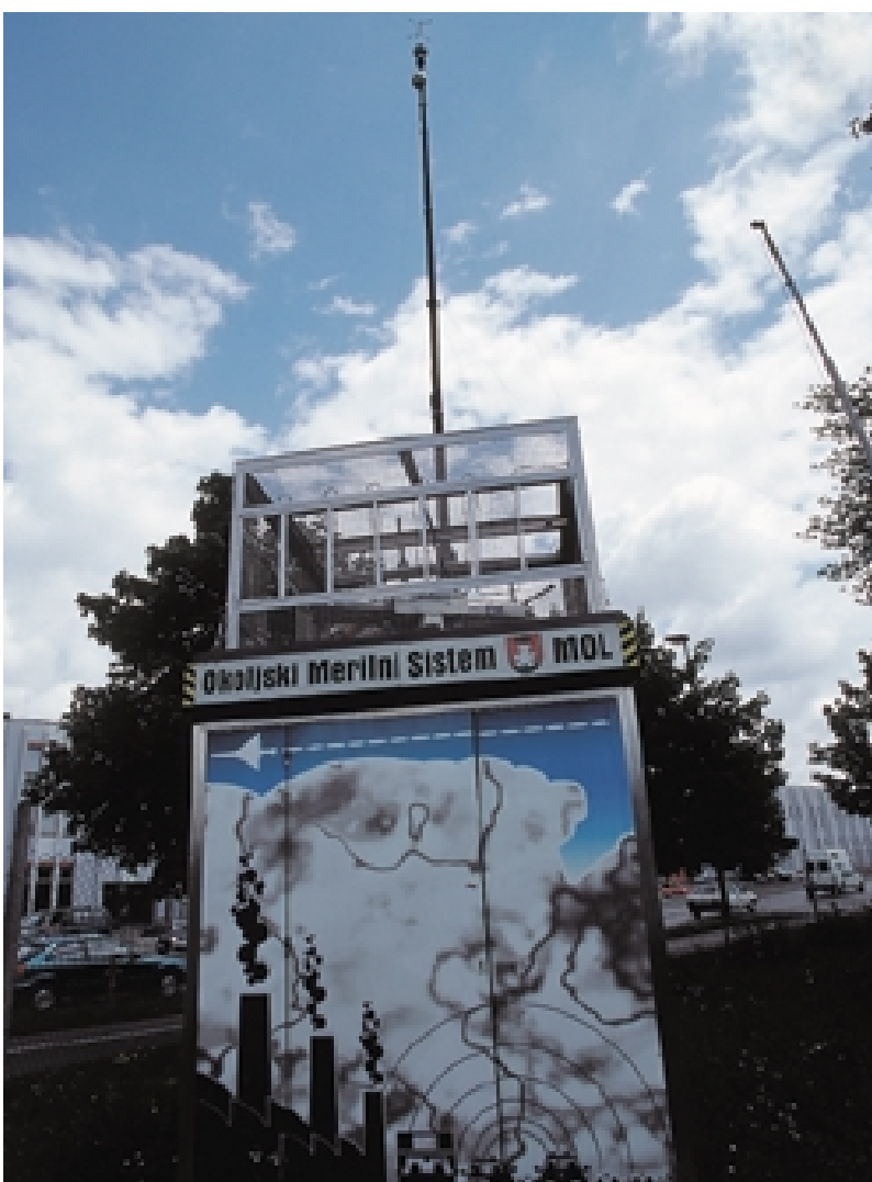
Slika 1-2: Okoljski merilni sistem na križišču Kajuhove ulice in Letališke ceste v Mostah
