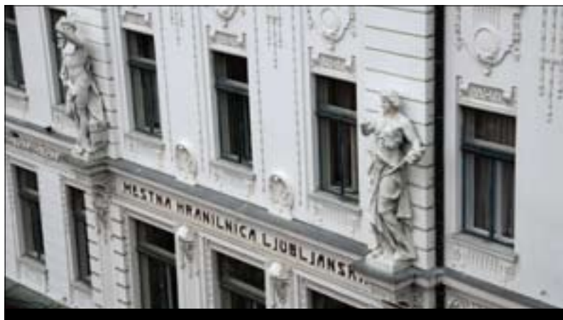
Preново ene najlepših secesijskih stavb v Ljubljani je leta 1999 izvedel Restavratorski center. Na pročelju sta poleg štukatur lepo obnovljena tudi kipa alegorij trgovine in proizvodnje.
