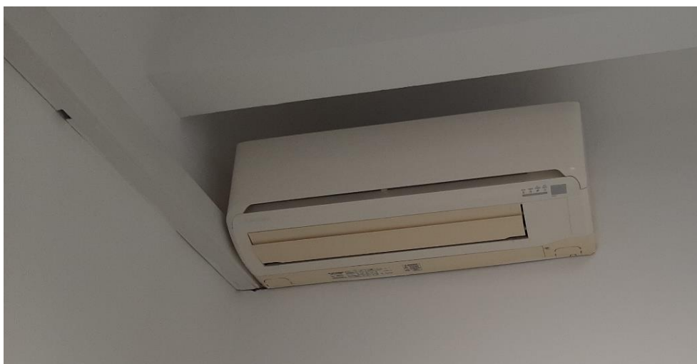
Slika 4.5: Notranja enota »split« klimatske naprave
